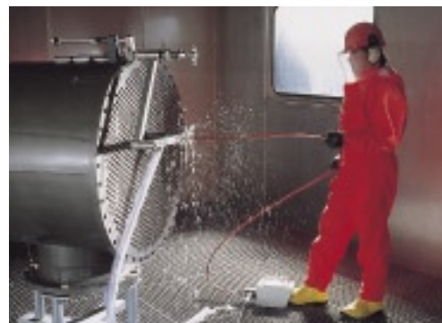
Ручная и автоматическая чистка теплообменников с помощью водоструйного оборудования URACA UHP
